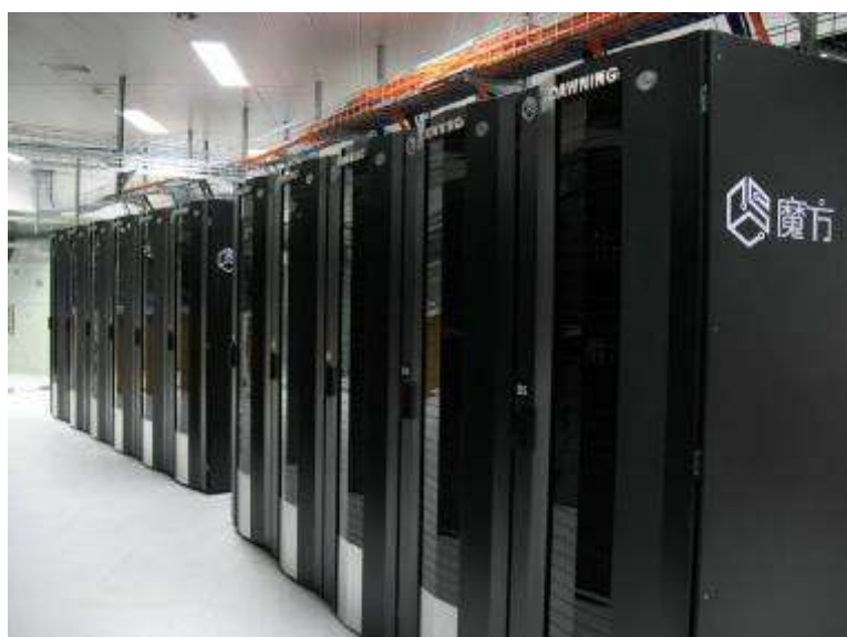
图表 34 封闭式水冷机柜应用
